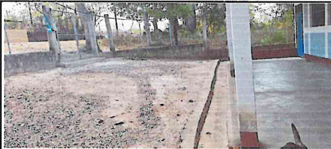
Foto 1: Mantenimiento correctivo a la entrada del establecimiento, se encuentra en malas condiciones.
